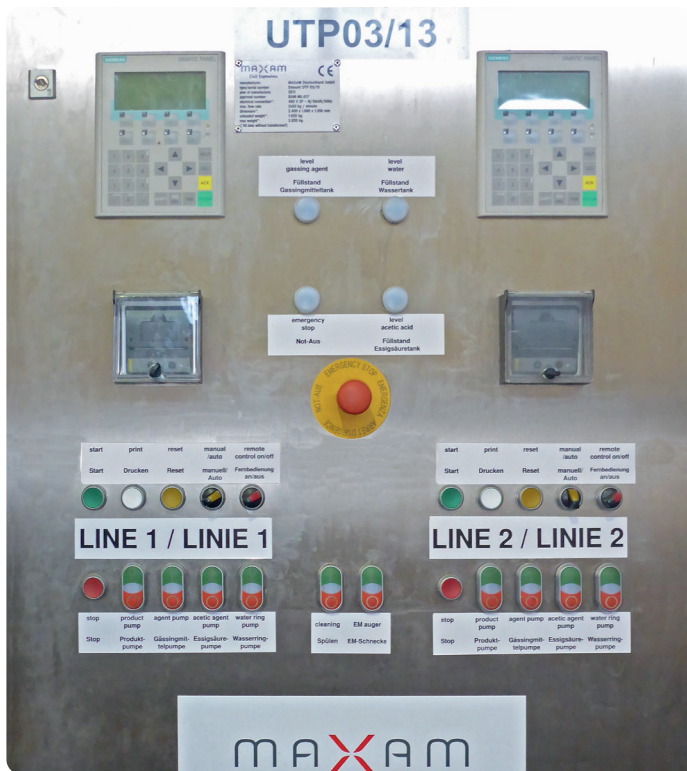
RIOMEX Anwendung Untertage: Bedienfeld Pumpeinheit. RIOMEX bietet hervorragende Wasserfestigkeit und ausgezeichnete Fragmentierung.
